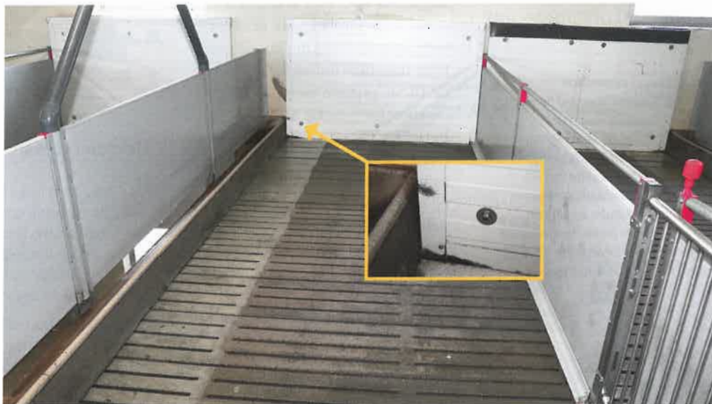
Grisene beskadigede ikke samlingerne mellem to sandwichelementer monteret på endevæggen i en slagtegrisesti, men ujernsskinnen ved krybbe-kanten blev ridset, og der var rustudvikling på ujernsskinnerne ned mod gulvet.
